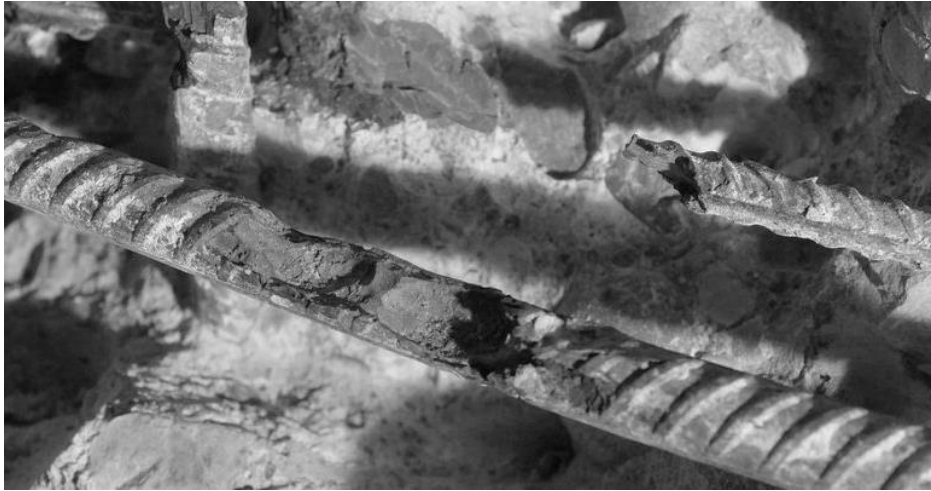
Beispielfoto: Korrosion durch Chlorideinträge
